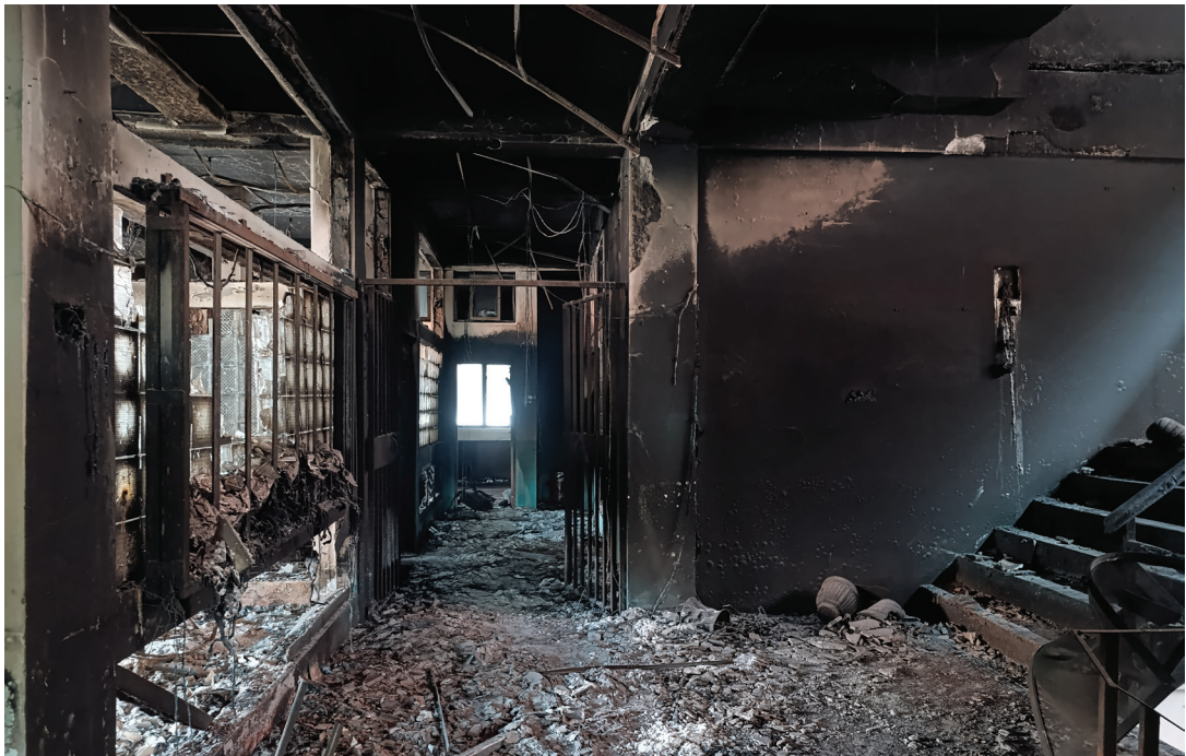
जेन्जी प्रदर्शनपछि जलेको अवस्थामा सचिवालय भवनको दोस्रो तल्ला
