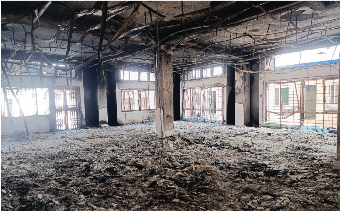
जेन्जी प्रदर्शन पश्चात् क्षतिग्रस्त बागमती प्रदेश सभाको पुरानो भवन
